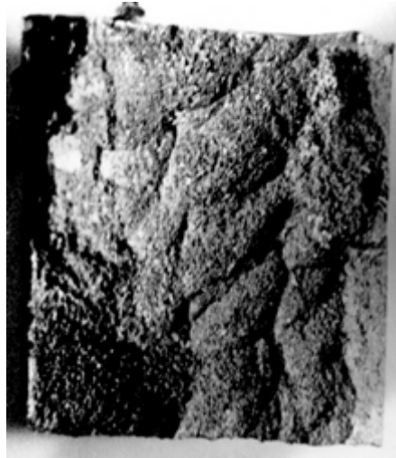
Рис. 6.12. Локальные разрушения по линии сплавления
