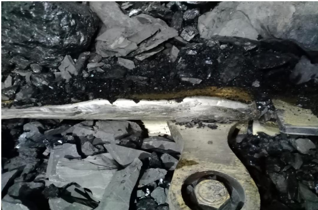
Рисунок 5.3 – Износ направляющей решетки с забойной стороны
